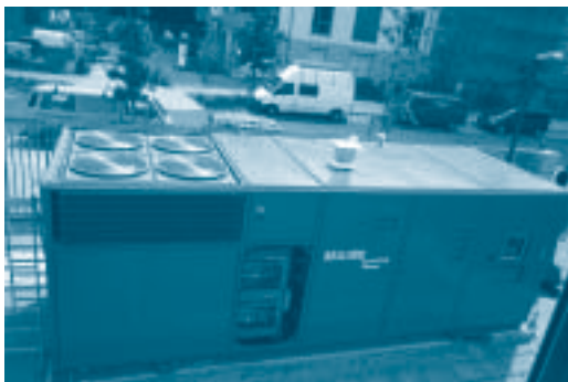
Cèl·lula de combustible de 250 kWh alimentada amb gas natural en fase experimental instal·lada a Berlín, de la Ballard Power Systems. Una cèl·lula consumeix 0,025 litres d'H 2 per kWh generat.
