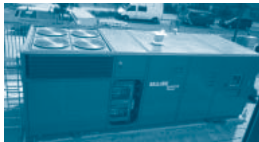
Célula de combustible de 250 kWh. alimentada con gas natural en fase experimental instalada en Berlín, de la Ballard Power Systems. Una célula consume 0,025 litros de hidrógeno por kWh. generado.
