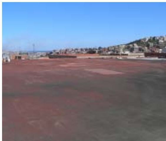
La cubierta del Mercat del Carmel, escogida para el proyecto de la primera OLA SOLAR.
